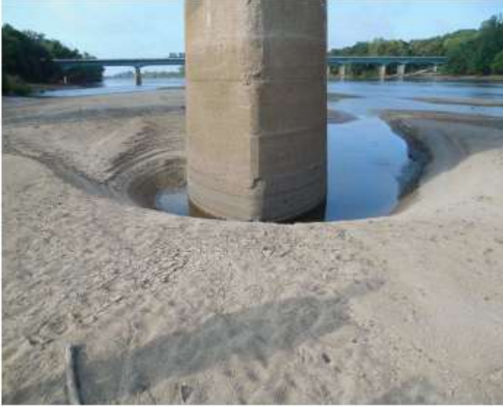
Şekil 1. Köprü ayağı etrafında oluşan oyulma örneği (Wardhana ve Hadipriono [20])
