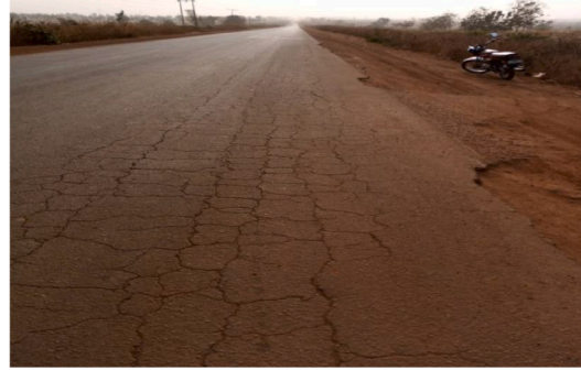
(d) Pavement with alligator cracks
